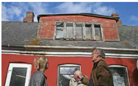
"Huset er brandfarligt. Det er sundhedsfarligt og det er nedstyrtningsfarligt", siger advokat Gert Verner Jørgensen . (th.) Til venstre LLO's landsformand, Helene Toxværd . I midten (delvist skjult) formanden for LLO i Kolding, Peer Marfelt .
