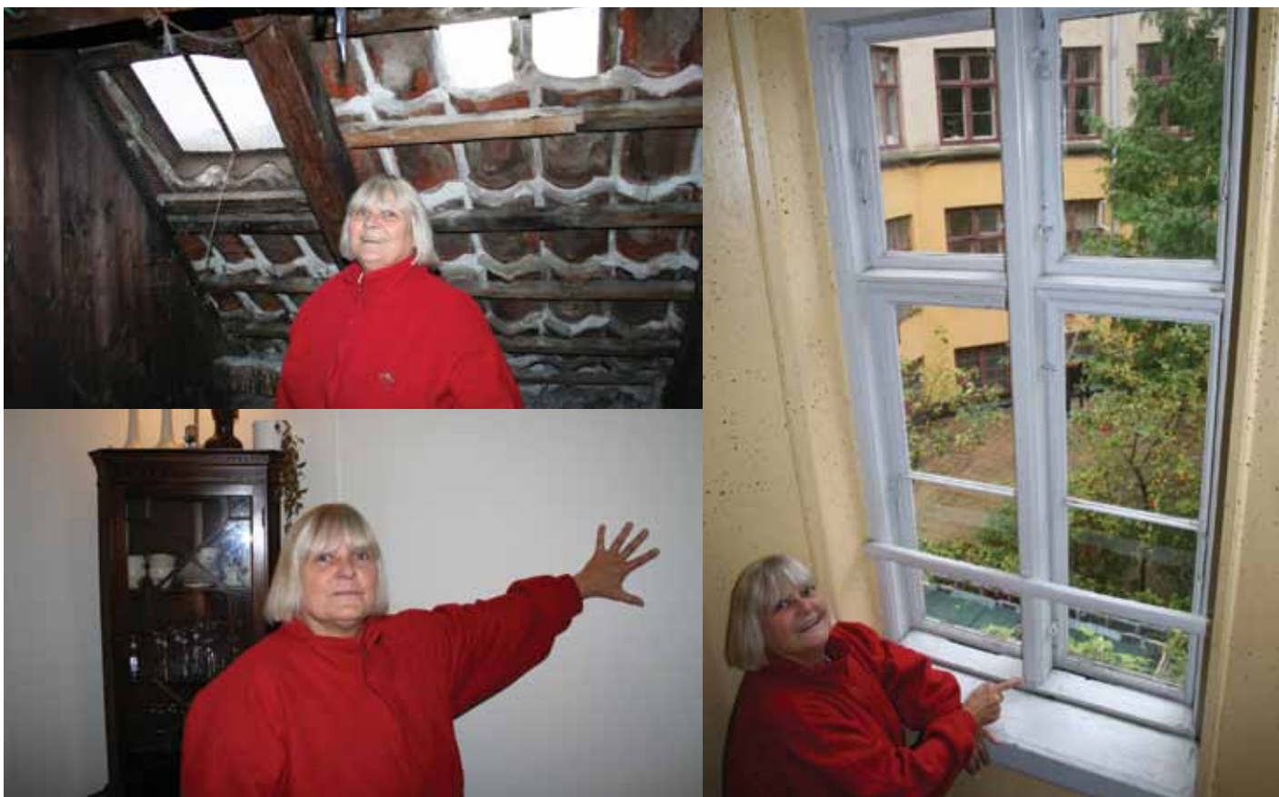
Tre eksempler på samme problem: ingen isolering i taget og på loftet, ingen isolering mellem lejlighederne og enkeltglas i vinduerne på bagtrappen.
