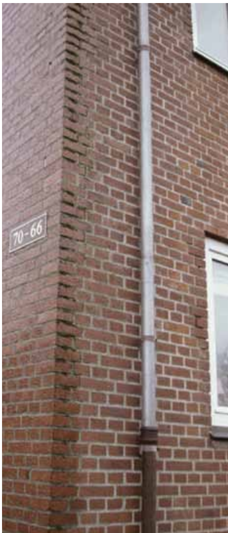
Gavlen til Kurt Triers lejlighed er af teglsten og sydvendt. Det giver ofte vandindtrængen, fastslår dommen. Billederne her er fra vinteren 2007 og viser tydeligt mos hele vejen op langs hulmuren på siden af bygningen.
